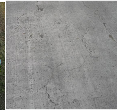
Sprungur vegna steypuhita
